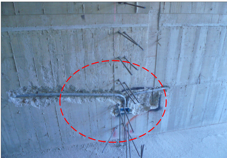
預留鋼筋未事先綁紮以植筋施作、管線未事先埋設
