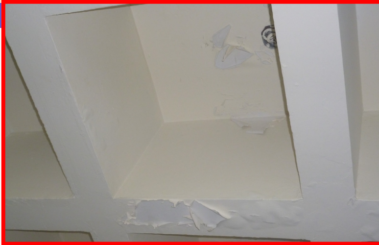
屋頂漏水致油漆脫落
