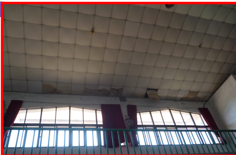
屋頂漏水致天花板掉落
