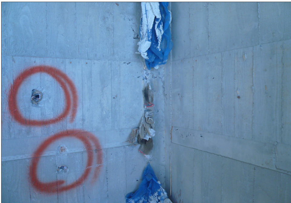
混凝土表面夾板、手套、報紙未拆除
