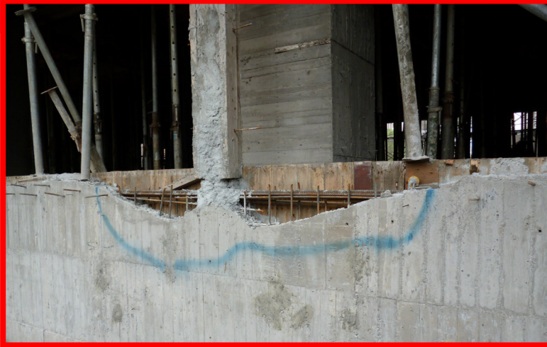
混凝土澆築不佳
