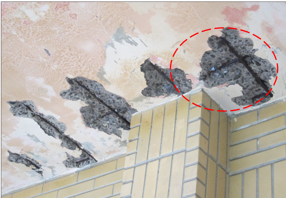
鋼筋保護層不足
