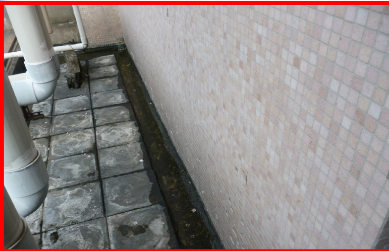
陽台導溝未整理
