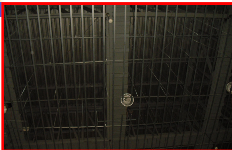
天花板吊筋未依規定施做
