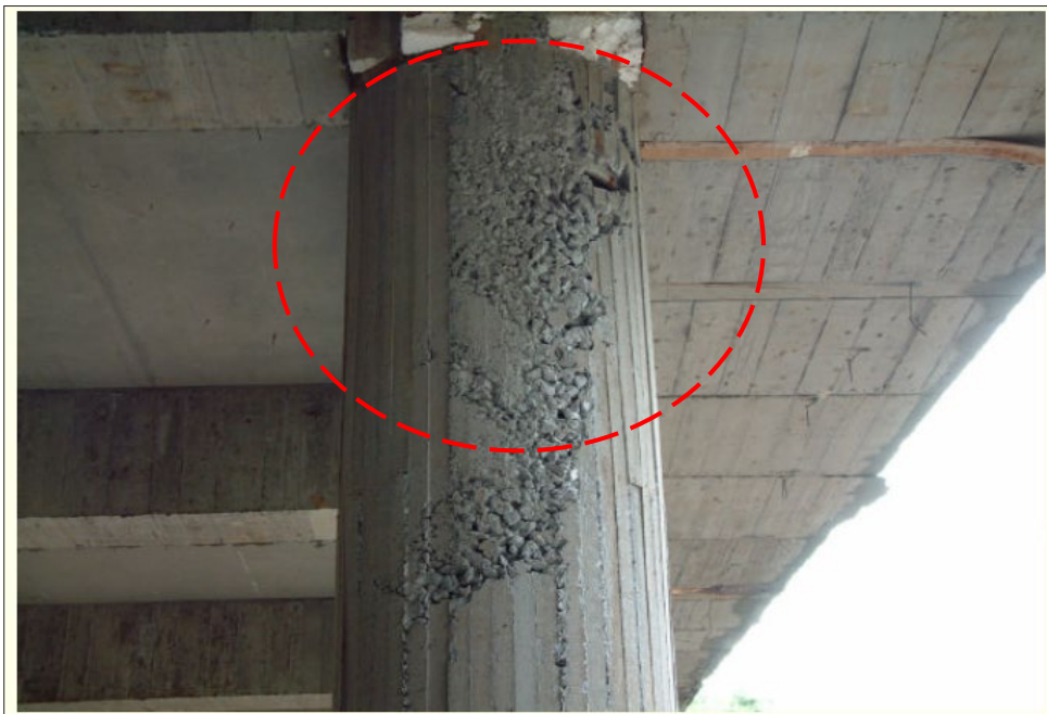
混凝土表面蜂窩，夾板、保麗龍、鐵釘未拆除
