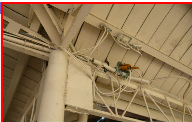
舊有電線未妥善規劃
