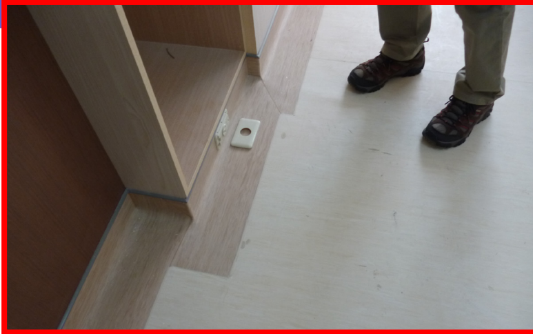
施工未考慮周詳
