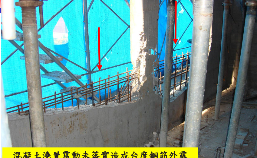
混凝土澆置震動未落實造成台度鋼筋外露
