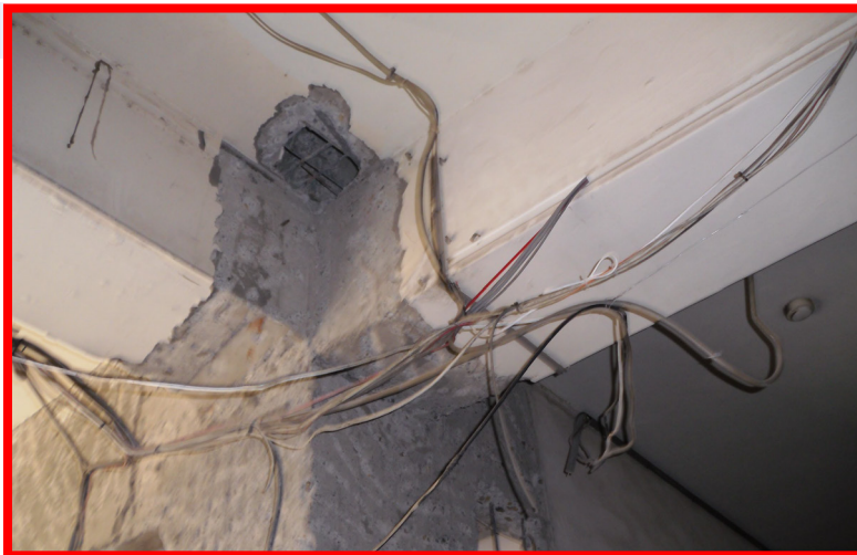
舊有電線應整理及檢測
