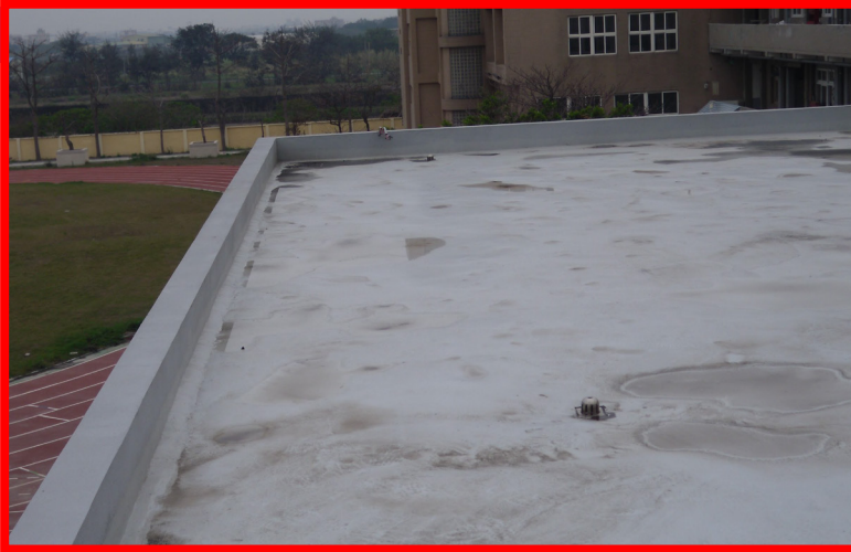
底版不平整 有積水情形
