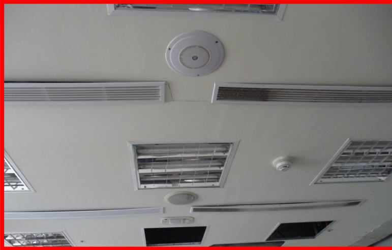
暗架天花吊筋不足導致變形
