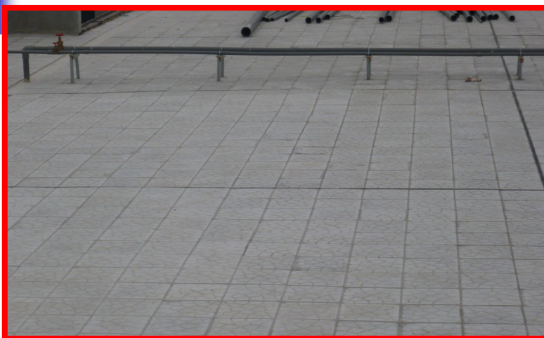
隔熱磚未設置伸縮縫
